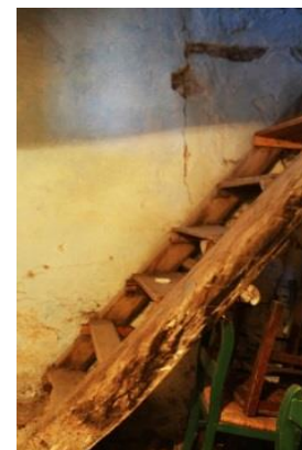
φωτογραφία 3 ρωγμή δίπλα από την σκάλα
