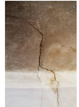
φωτογραφία 2 ρωγμή πάνω από την δίφυλλη πόρτα
