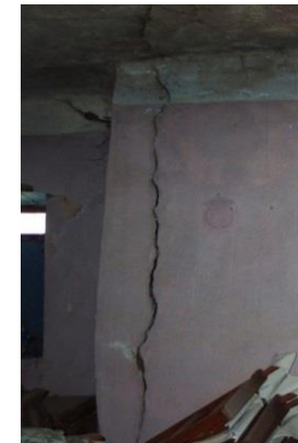
φωτογραφία 1 ρωγμή κοντά στην γωνία του τοίχου και στην ψευδοροφή
